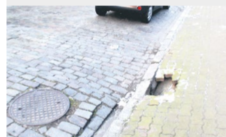
Zapadnięty chodnik przy ul. Żółkiewskiego
