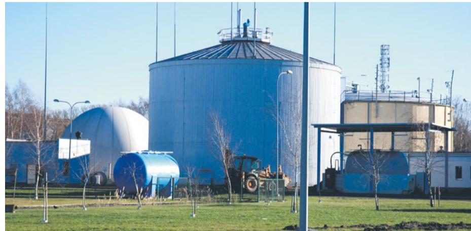
Dzięki nowej komorze fermentacji w oczyszczalni powstawać będzie więcej biogazu.
