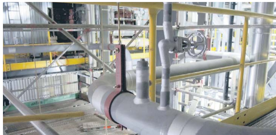
Fragment rurociągu do obiegu pary.
