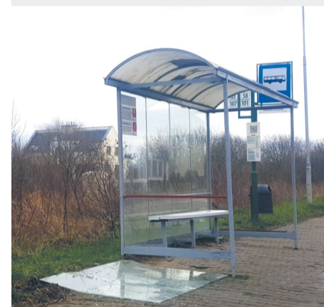
ul. Kolonistów - uszkodzona szyba na przystanku
